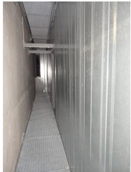
18 - Vide technique entre la façade et les murs de bétons du bâtiment pour garantir température et humidité constante.
